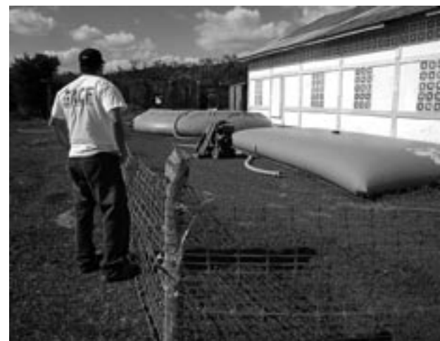
Depósitos de agua potable instalados durante la emergencia por el paso del huracán Félix, en la Zona RAAN (Puerto Cabezas).
