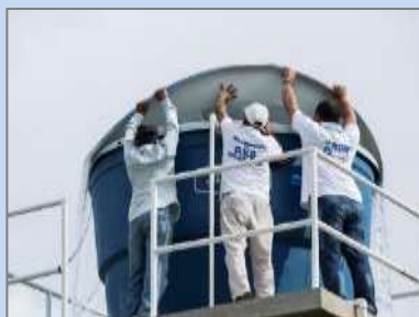
Tanque elevado (sistema colectivo)
